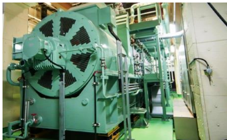
三島工場 ガスエンジン
